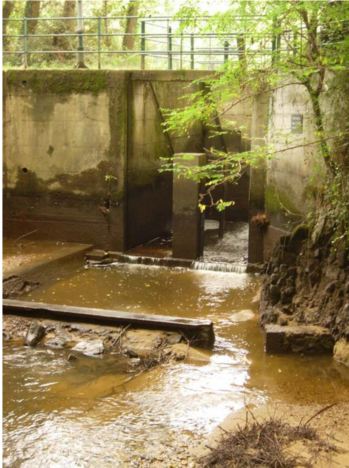
Partie amont de la passe à poissons du barrage de la Bageasse
